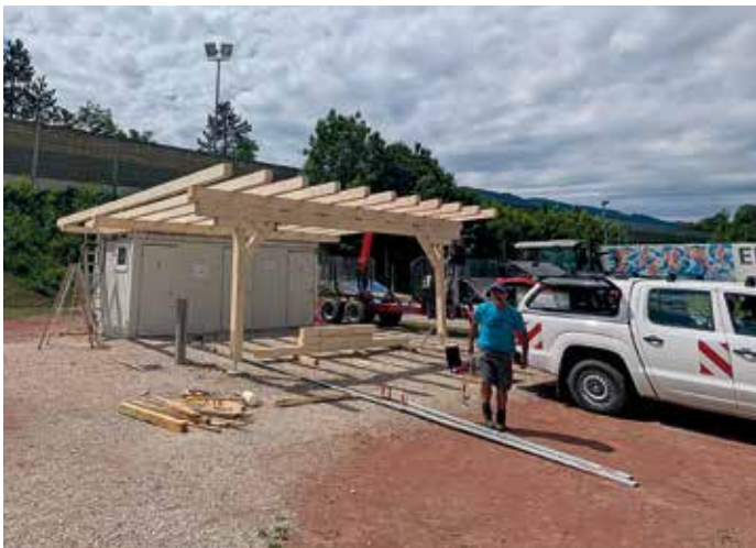
WC-Container mit Beschattung und Trinkbrunnen beim Ennspark.
